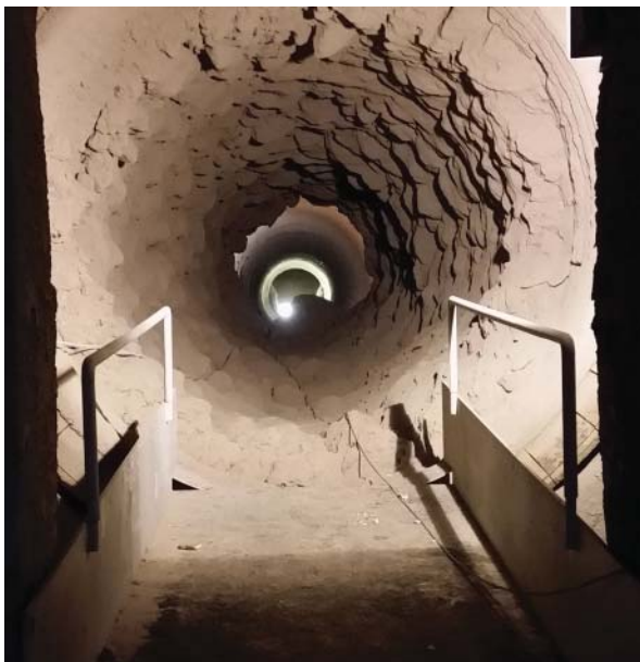
Abb. 1: Blick in einen Drehrohrofen mit NORM Ablagerungen aus der Zementproduktion (Foto: Universität für Bodenkultur Wien)
