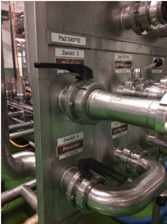
Abbildung 101: Eichanschluss an einer Bierpipeline
