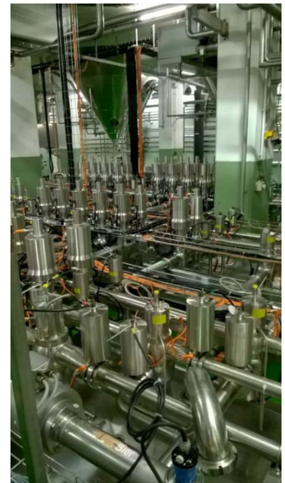
Abbildung 100: Steuerung der Biermengen über elektropneumatische Doppelsitzventile
